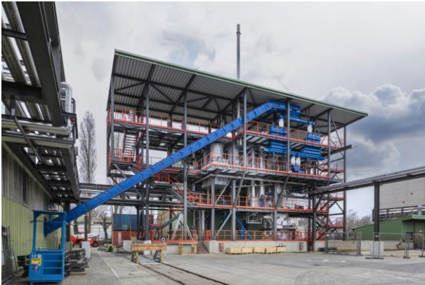
© Wien Energie, Christian Hofer
